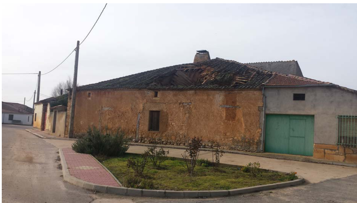
Fachada principal con desplome de la mampostería y cubierta.
