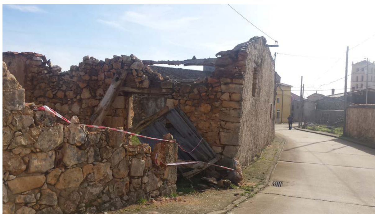
Fachada principal con desplome de la mampostería.
