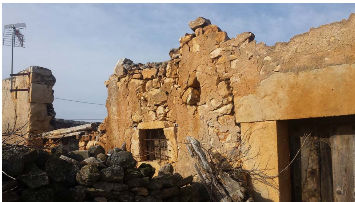
Muros sin rematar que presentan piedras sueltas.
