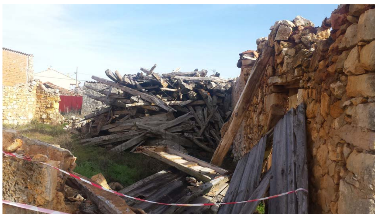
Restos de escombros sin recoger en el interior de la finca.
