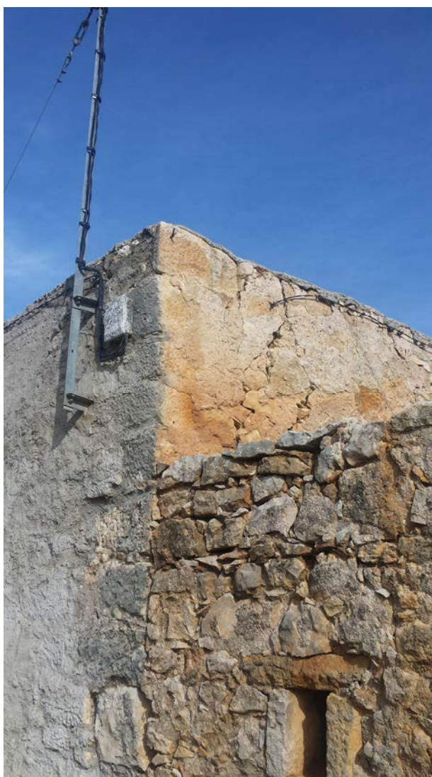
Gritas en las escuadras de los muros que dan a vía pública.
